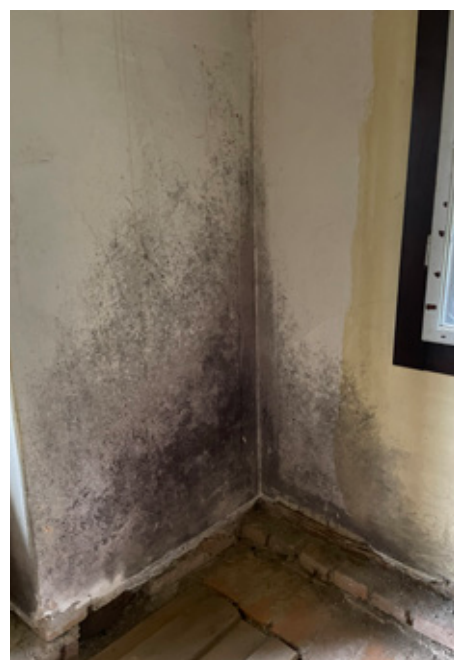
Slika 2: Zaradi neustrezne sestave sten, slabega prezračevanja in toplotnih mostov se na stenah pojavlja plesen.
