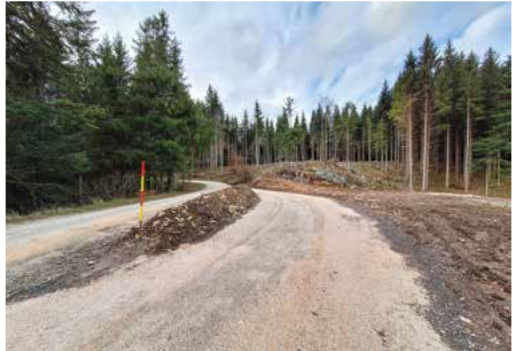
Vzdolžni priključek gozdne vlake na državno cesto z nivojsko nižjim uvozom in izvozom za odvodnjavanje, varovalno bermo za usmeritev prometa in varovanje vozišča med nakladanjem. V ozadju preusmerjena vlaka na skladiščni prostor na desni strani.
