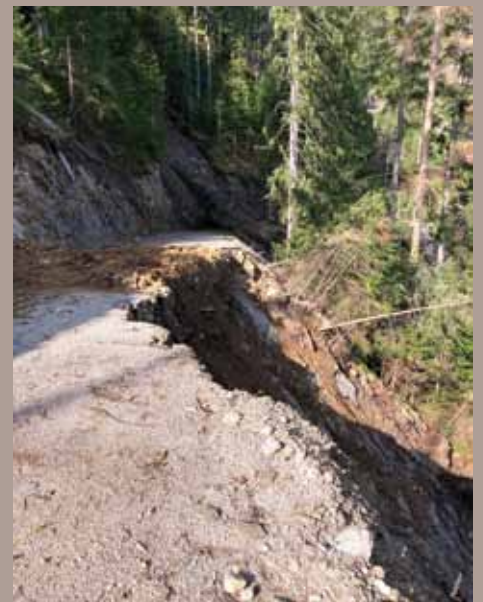
Neustrezno odvodnjavanje meteorne vode je najpogostejši vzrok usadov na gozdnih prometnicah.
